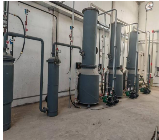
5#车间尾气处理系统
