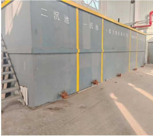
污水处理系统
