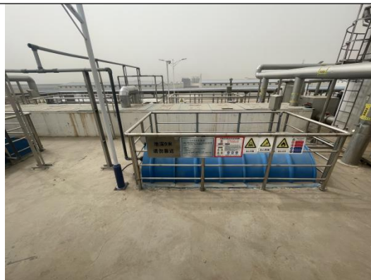
UASB 厌氧池（加盖，废气管道收集）
