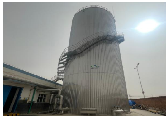
厌氧罐（IC 厌氧生物处理）
