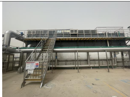
气浮池（加盖，废气管道收集）
