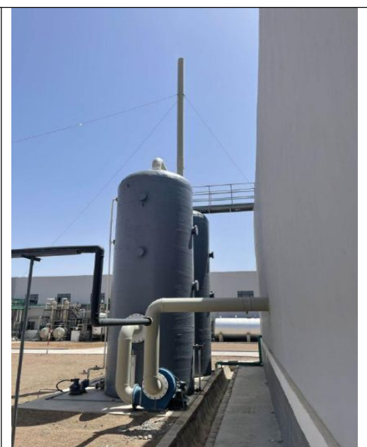
污水处理站废气处理设施
