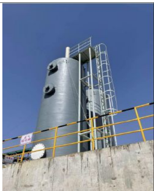
污水处理站废气处理设施
