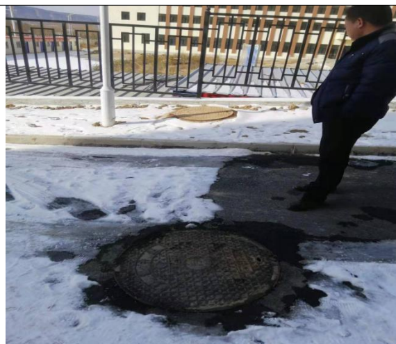
化粪池出口接入市政管网
